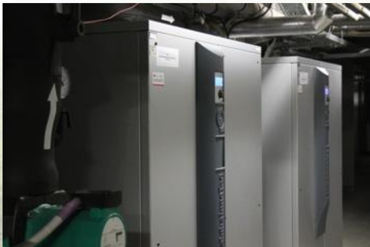
Pompy ciepła na basenie w Szczecinie
