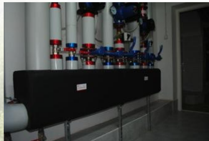
Instalacja w Domu Pomocy Społecznej w Krzecku
