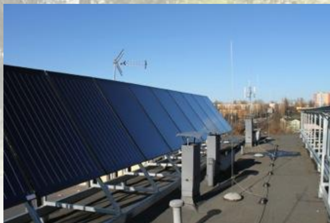
Instalacja solarna w Szpitalu Przeciwegruźliczym i Chorób Płuc w Koszalinie
